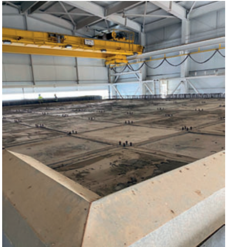
Celda de almacenamiento llena de contenedores de RBMA. /ARCHIVO ENRESA
