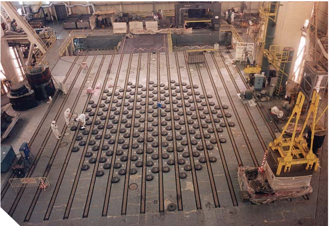
TRABAJOS SIMULTÁNEOS EN LA LOSA DEL REACTOR: SELLADO DEL CAJÓN Y DESMONTAJE DEL DPM
