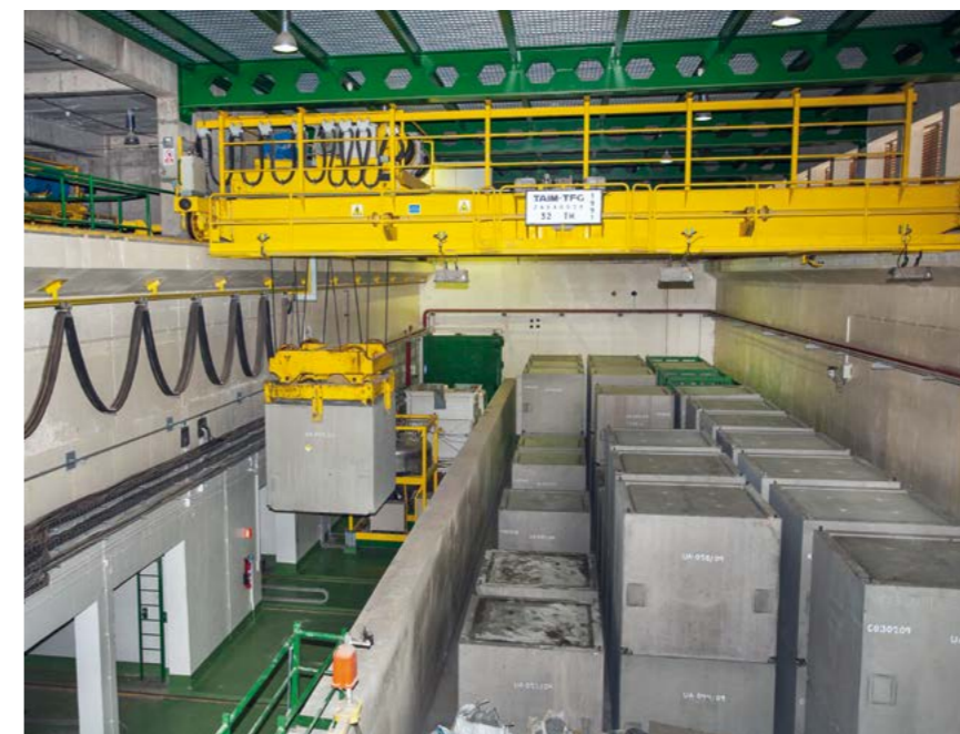
Contenedores de almacenamiento en la nave de acondicionamiento de residuos de El Cabril.
