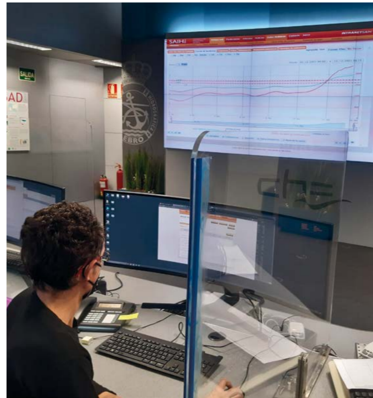
Sala de control del Sistema de Ayuda a la Decisión de la Confederación Hidrográfica del Ebro.
