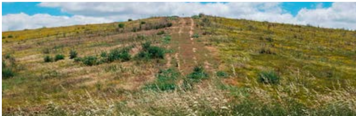
Los controles que se efectúan sobre el dique y su cubierta multicapa siguen demostrando que el conjunto es estable y cumple los objetivos de diseño.
