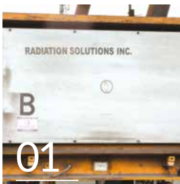
01 Detalle de un pórtico detector de radiación en ArcelorMittal, Olaberria (San Sebastian).
