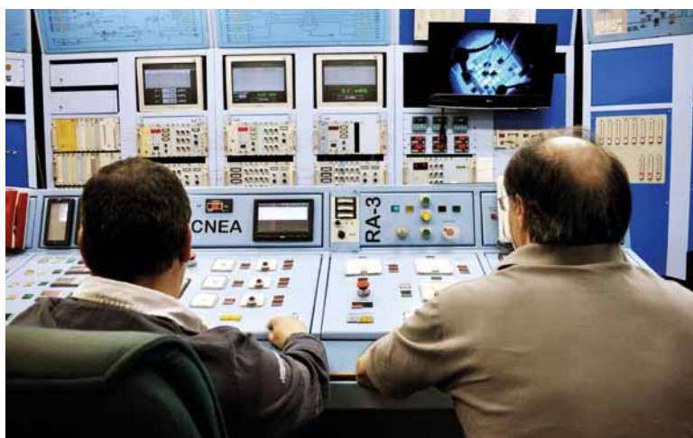
Sala de control del Reactor de investigación RA 3 del Centro atómico Ezeiza.
