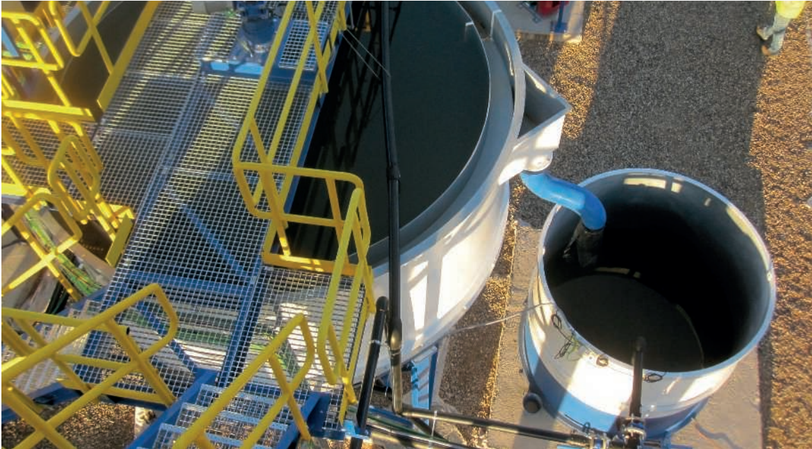
Recuperación de agua y deshidratación de finos. El material más fino y tras un proceso de decantación, se envía a la etapa de filtración.
