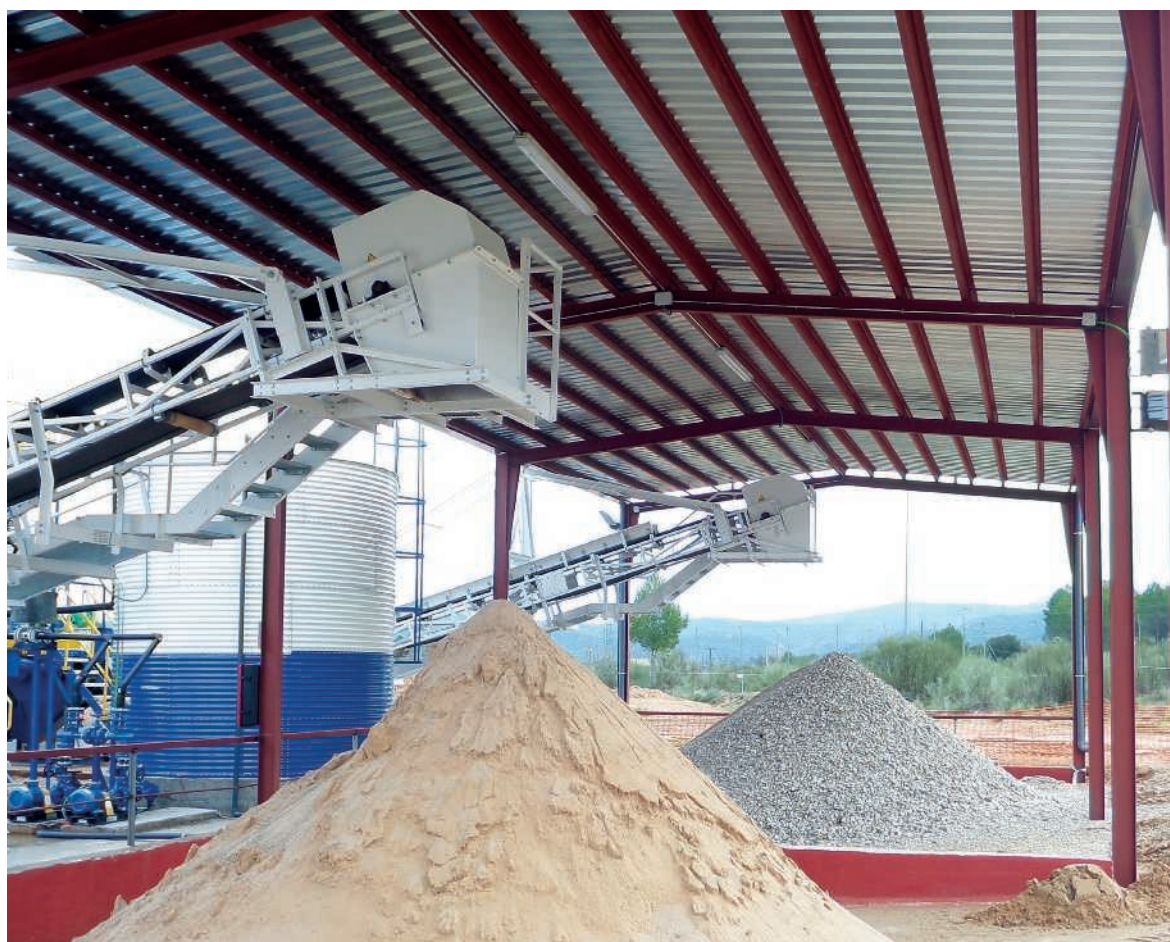
Separación de finos y lavado de arenas. La separación entre arenas y finos tiene lugar a través de dos fases de hidrociclonado, antes y después de proceso de lavado denominado atrición. Las arenas se descontaminan mediante un proceso de rozamiento desprendiéndose la contaminación adherida. Las arenas obtenidas, una vez escurridas, se conducen por medio de una cinta transportadora hasta el acopio de arenas desclasificables.
