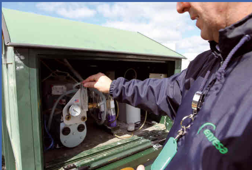
Estación de control de la calidad de aire en El Cabril.
