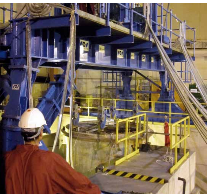
Las 120 toneladas de peso de la vasija llena de agua hizo necesaria la instalación de una estructura de izado hidráulico para su traslado.
