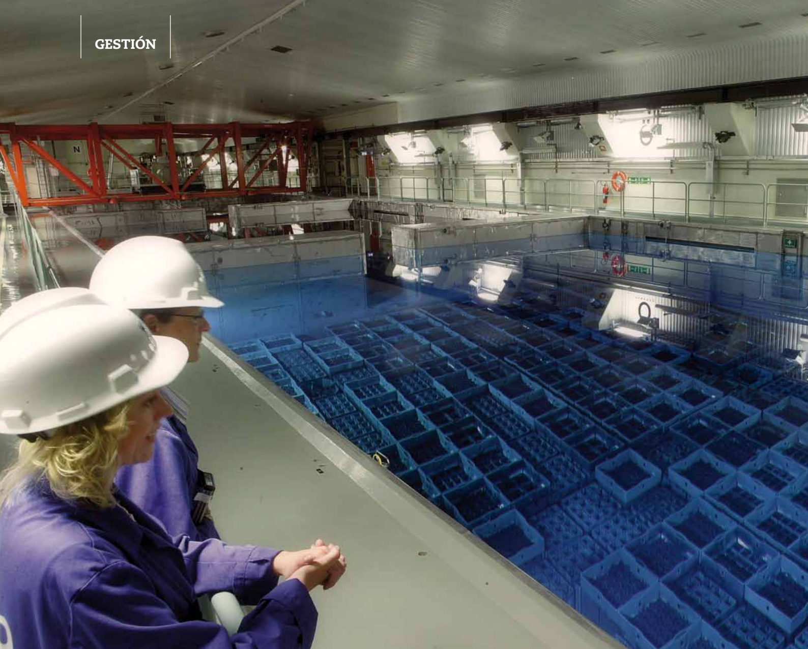
Piscina de Almacenamiento Temporal Centralizado CLAB (Suecia).
