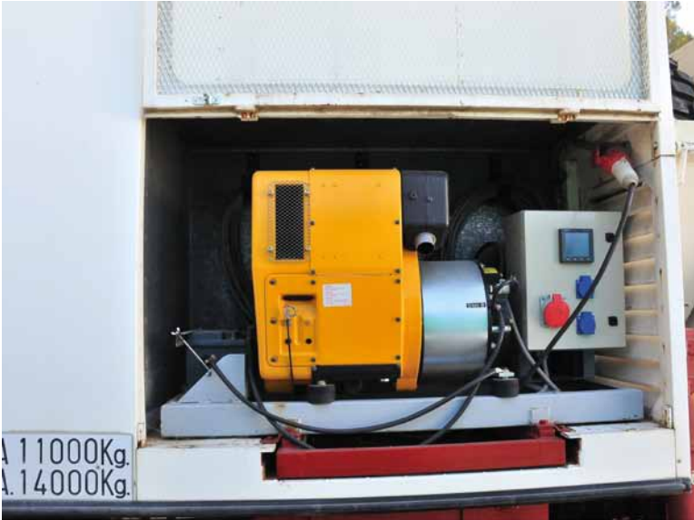
Grupo trifásico diésel de 9 KVA, con salida de 220 V, y con rejillas exteriores de ventilación.
