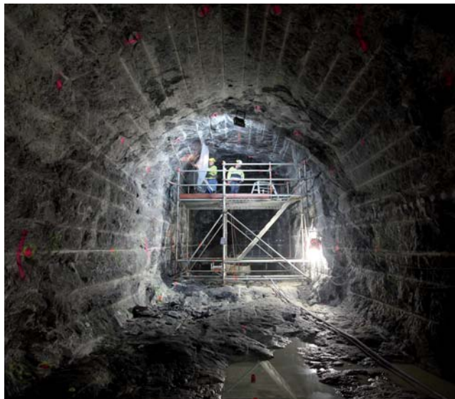
Túnel del laboratorio subterráneo de Onkalo en el emplazamiento de Olkiluoto. / POSIVA
