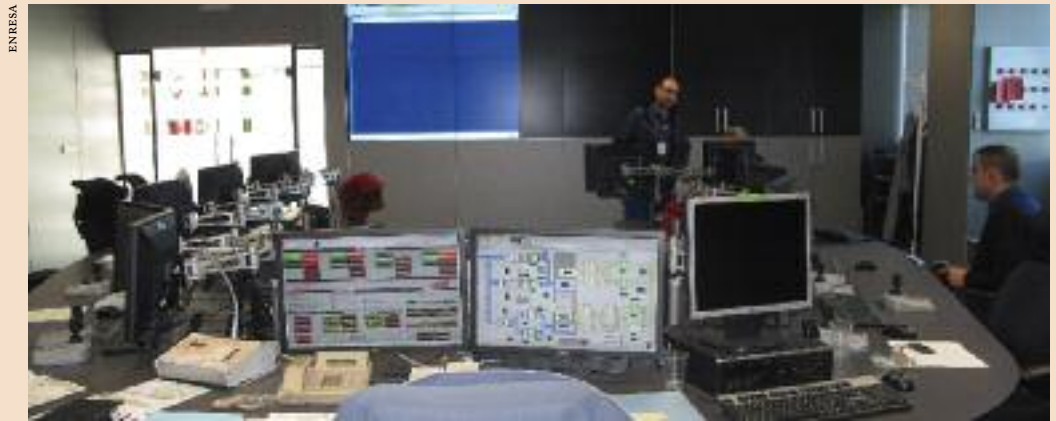
La nueva sala de control de El Cabril cuenta con dos puestos de operación y seis de supervisión.
