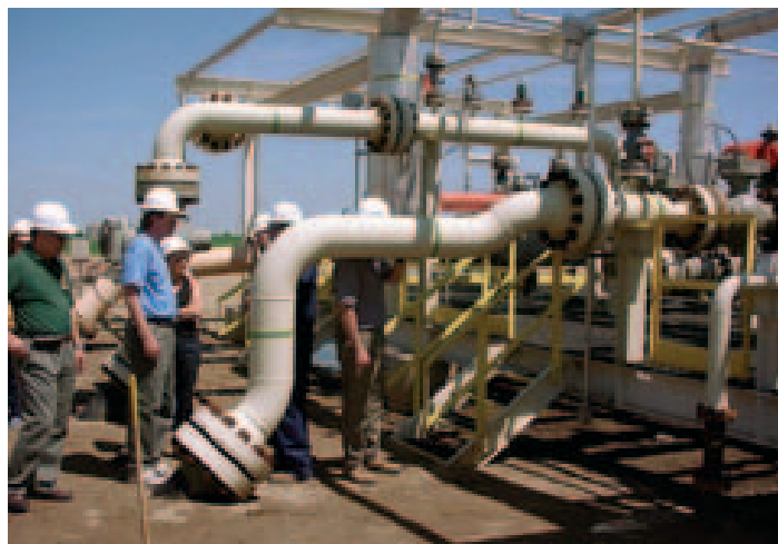
Planta de almacenamiento geológico de CO 2 en Weyburn, Canadá.
