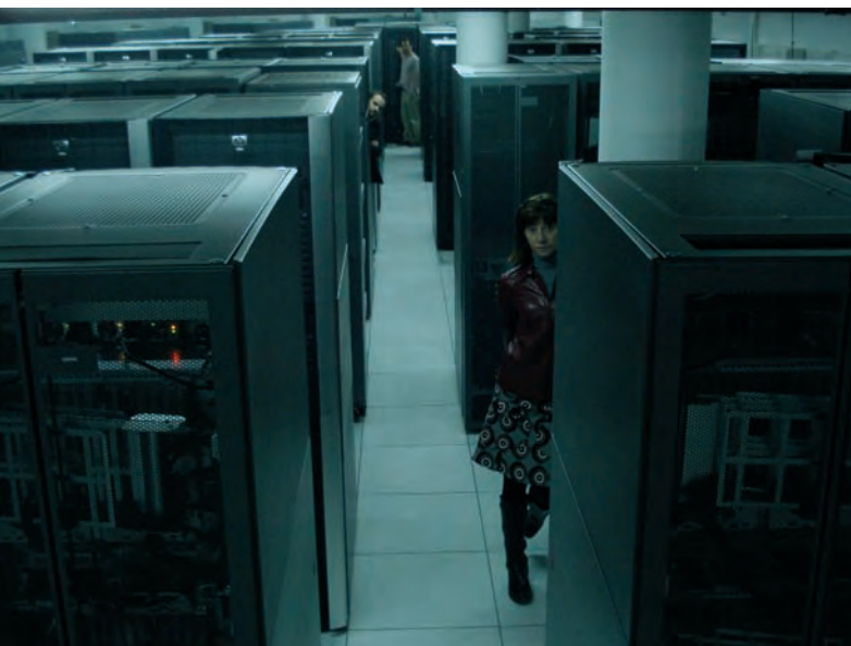
Ordenadores del Centro de Supercomputación de Galicia.
