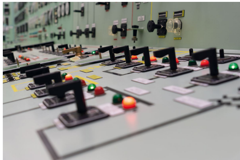
Detalle de un panel inferior de la sala de control.
