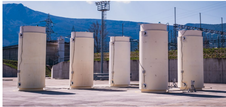
Vista del Almacén Temporal Individualizado de la central con los 5 contenedores.
