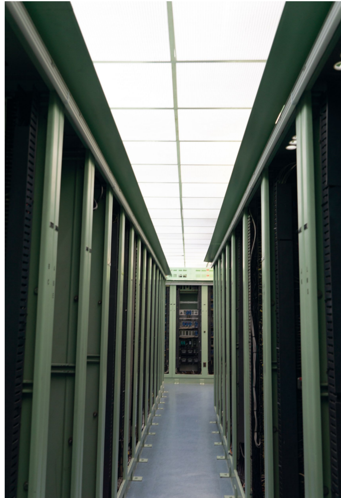
Detalle de la sala de control.
