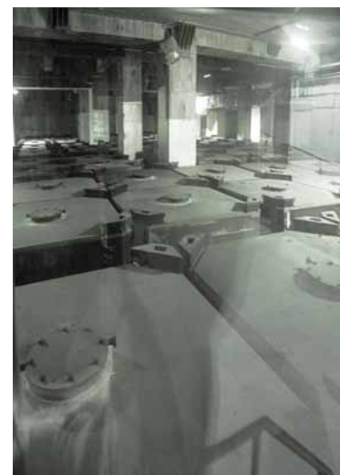
Contenedores de almacenamiento de grafito en la cava del reactor de Vandellós I.
