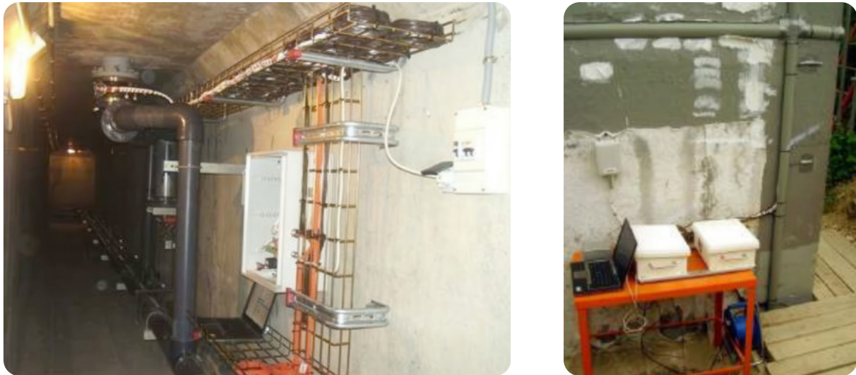
Figura 5-31: Sistema de adquisición de datos en la galería RCI de la celda nº 1; sistema de adquisición de datos de la celda 16 durante la fase de montaje
