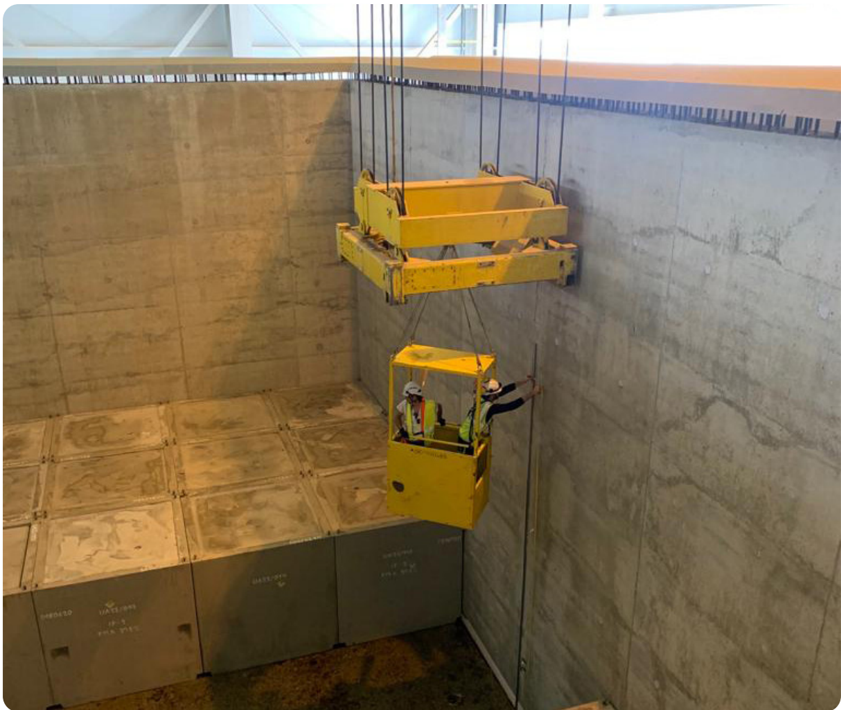
Figura 4-1: Instalación de sensores en la celda 21 del C.A. El Cabril
