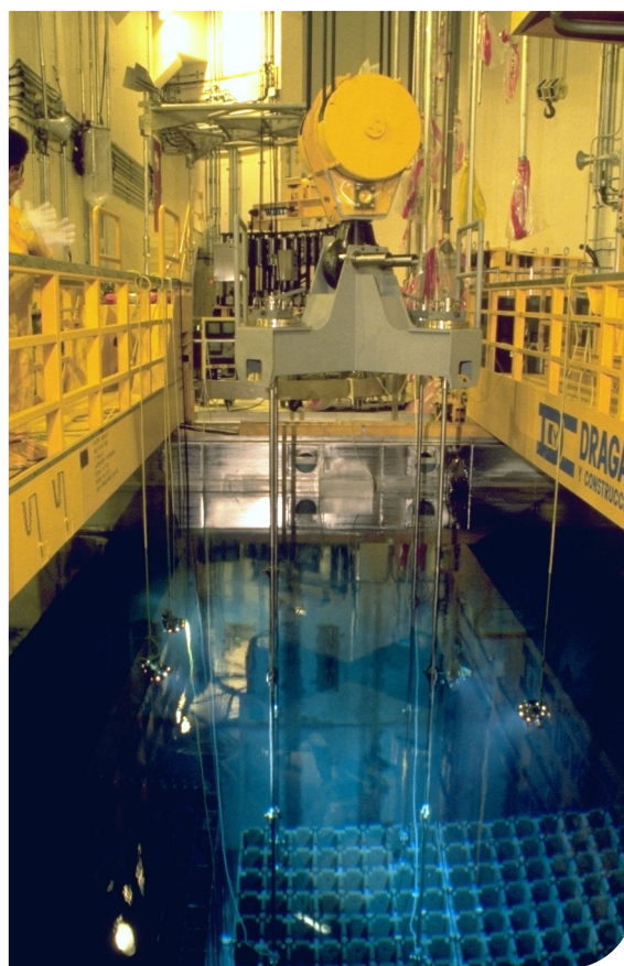
Figura 13. Piscina de almacenamiento de CG
