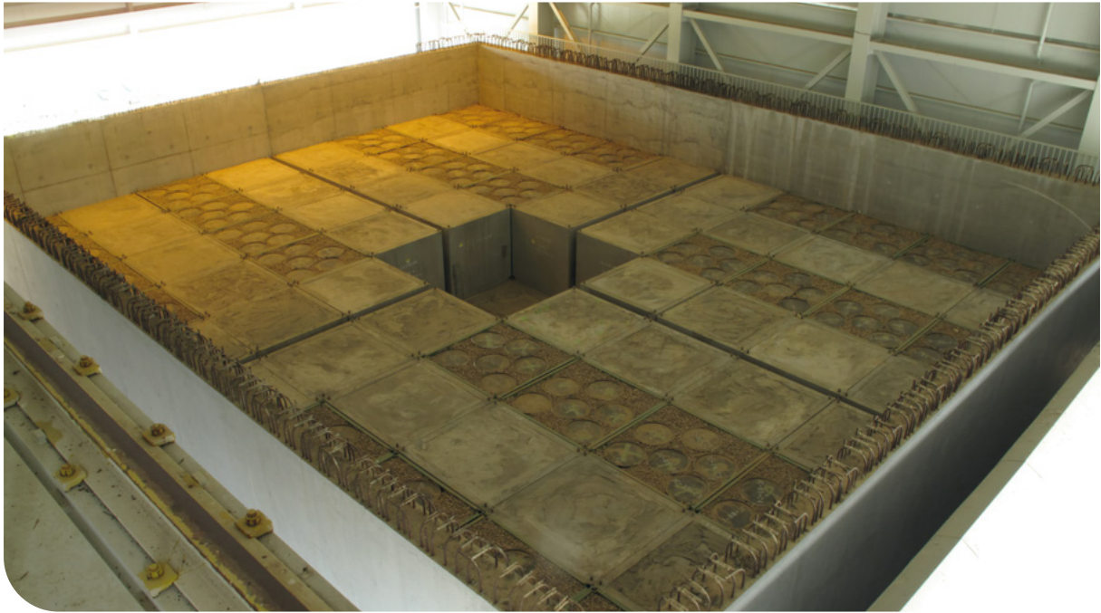
Figura 11. Celda de almacenamiento de RBMA
